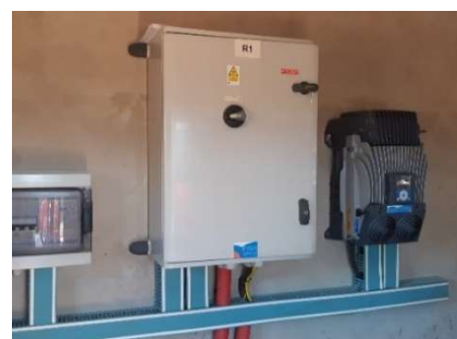
Disjoncteur, inverseur et convertisseur solaire
