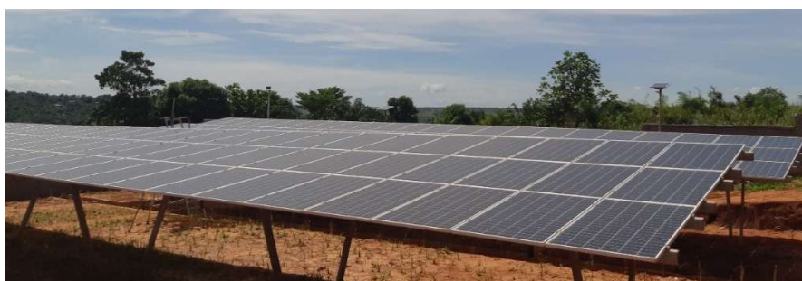
Une des centrales photovoltaïques mise en place par le projet
