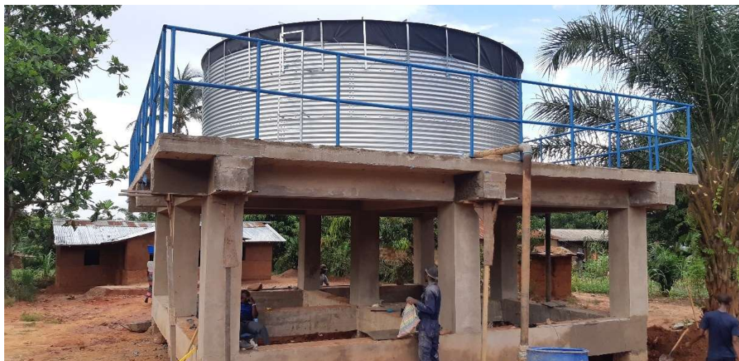
Réservoir 75 m 3 d'extension du réseau R7
