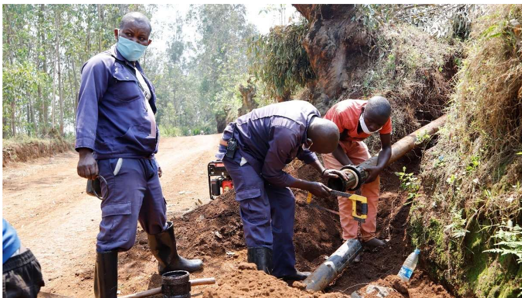
Jonctions entre 2 conduites, réseau de Mwendo/Mudaka qui a nécessité de multiples interventions
